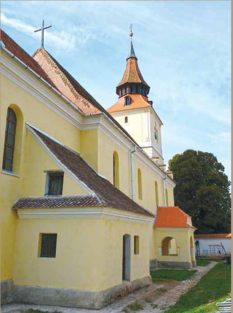
Die evangelische Kirche in Brenndorf erstrahlt rundum in neuem Glanz, nachdem im Sommer 2019 die Nordseite des Gotteshauses renoviert wurde. Der Sockel muss noch ein Jahr austrocknen.
