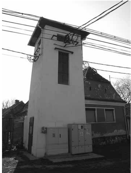
Der Transformator an der Kreuzung Honigberggasse/Kirchgasse stand bereits, als 1914 die Straßenbeleuchtung in Brenndorf eingeführt wurde. Aufnahme aus dem Jahr 2014. Foto: Manfred Copony
